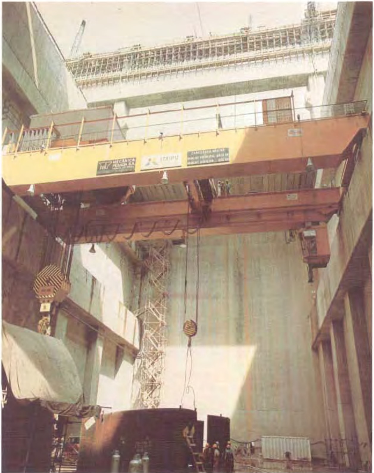
Una vista de las instalaciones del área de montaje derecha, con puentes grúas en plena utilización.
