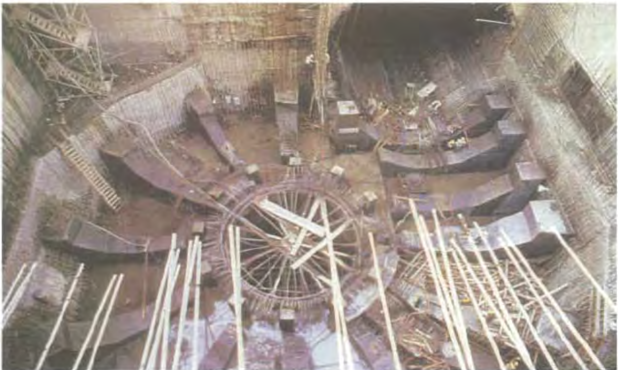
Dos instantáneas de la secuencia del montaje, en la central, del revestimiento del tubo de succión de la turbina N° 1.
