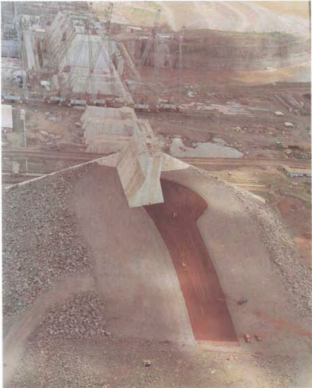
Una vista del punto de transición en la construcción de la Presa de Hormigón y la Presa de Enrocado, situado en el extremo izquierdo de la central hidroeléctrica de Itaipú.
